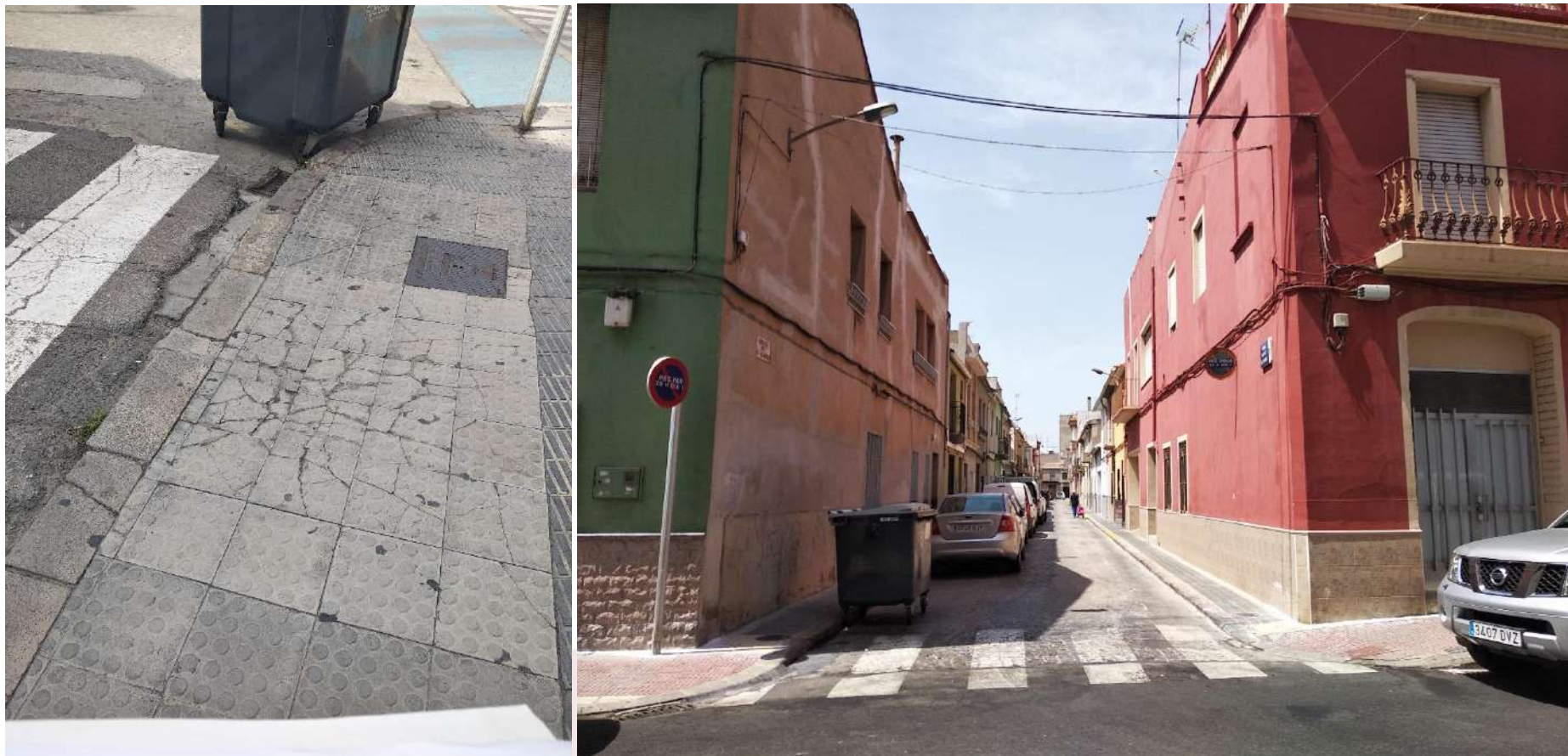
Imagen 6-15 Foto izquierda: acera destrozada. Calle Camí d'Onda. Foto derecha: pendientes mal resueltas en los vados peatonales. Calle Menéndez Pelayo. Elaboración propia.
