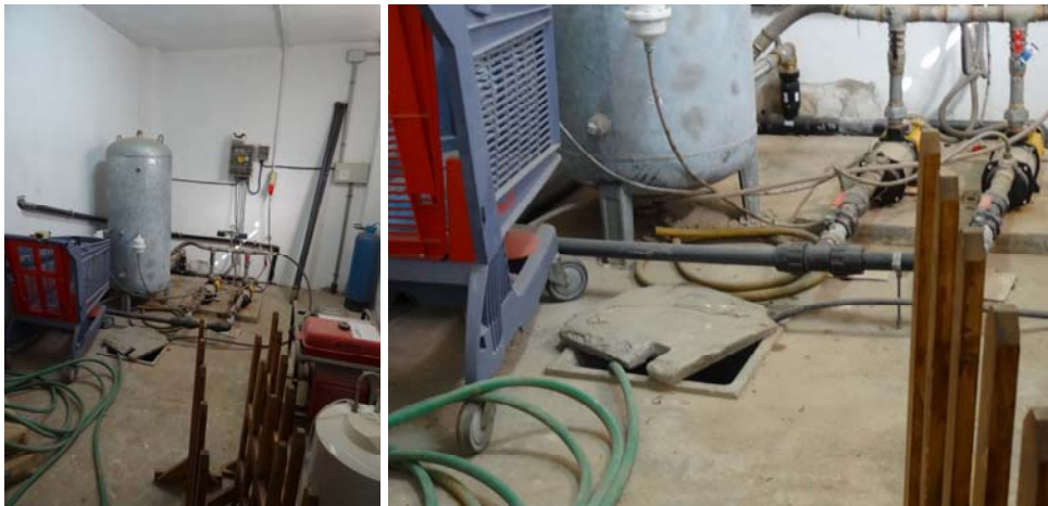
Instalaciones. Algabe de agua
