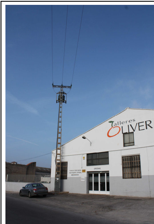
FOTO Nº10 Red de M.T. aérea existente en la zona
